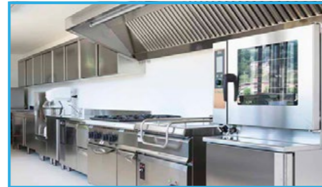
Hệ thống hút khói bếp cấp gió
